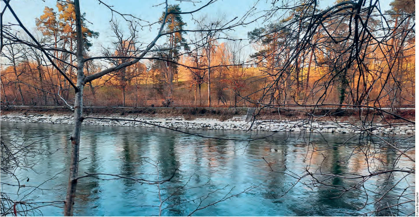
Marode Ufersicherungen an der Aare bei der Elfenau. (Blick auf die Elfenau von der rechten Aare-Seite).
