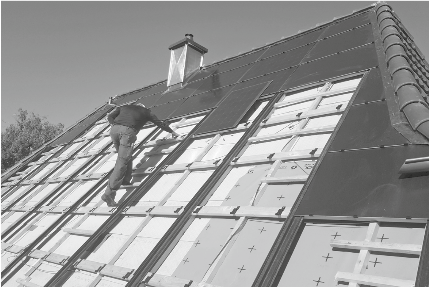
Panneaux solaires : une mesure importante de la loi bernoise sur l'énergie en faveur du renouvelable. © Baur AG
