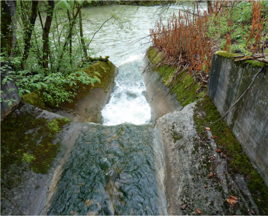
Ein steiler Absturz und eine harte Sohle: Das ist ökologisch wenig wertvoll. Der Bach soll in Zukunft flacher verlaufen und ein Kiesbett erhalten. © Simon Fankhauser
